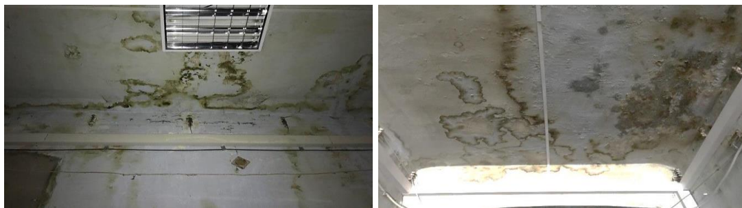
Рисунок 7. Разрушение штукатурки и плесень на потолке в общем коридоре на 1-м и 2-м этажах
