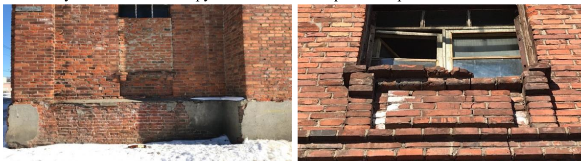
Рисунок 5. Разрушение внешнего слоя и подоконного участка кладки несущей стены
