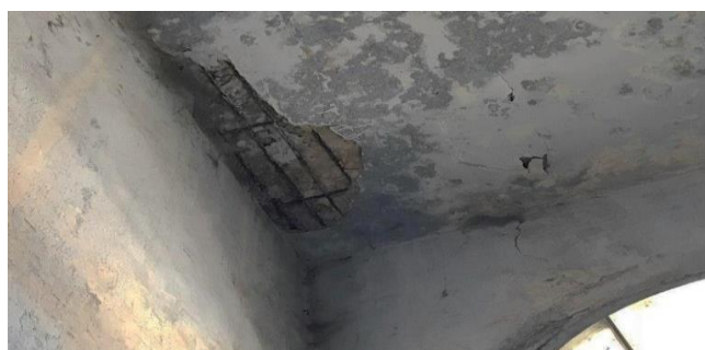
Рисунок 6. Частично разрушенное перекрытие
